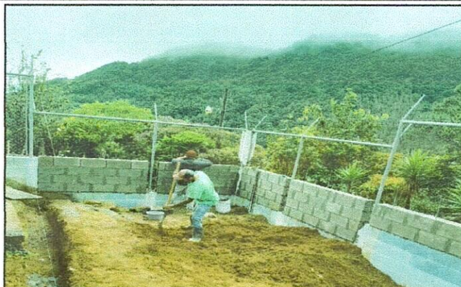
Foto 2: Avance en el patio de la escuela es necesario reparar una parte del muro de contencion ya que esta dañada por las lluvias.
